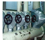
蒸気ヘッダー
