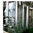
ボイラー全体
