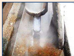
フラッシュ蒸気ドレン排出
