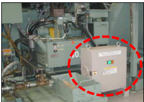
油圧ユニット(タンク+ポンプ+電動機) (赤いマルの中がインバーター制御システム)
